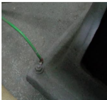
【접지 정상 설치 상태】
