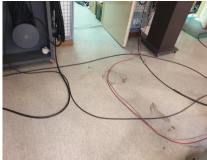
【통로에 설치된 전기선】
